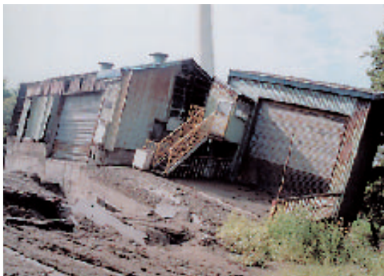
写真6 断層によって傾いた焼却場。 Photo6 Damaged factory by fault.
