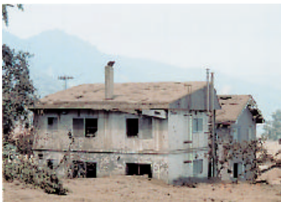
写真2 洞爺湖温泉町の降灰状況。屋根の上に多数のインパクトクレーターが認められる。 Photo2 Ash falls in Toya-ko Town. Many impact craters are observed on the roof.
