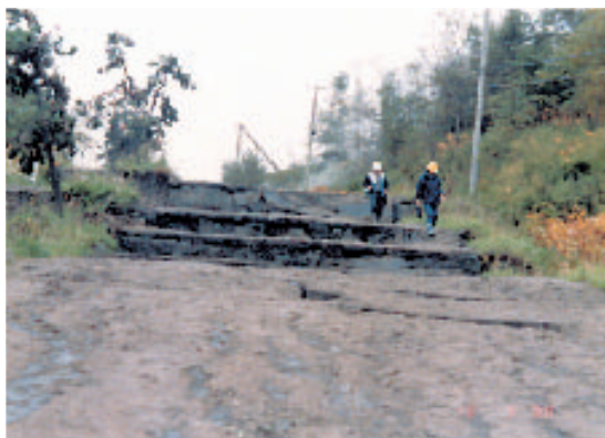
写真4 虻田町道公園線には沢山の断層が入った。 Photo4 Many faults cut the road near Route 230.
